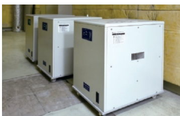
停電時でも電力を確保するため営業本部に設置されたリチウムイオン蓄電池
